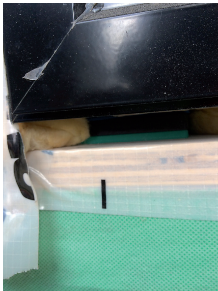
Sekundärtätning under ett fönster där stomskyddet utgörs av en vindduk. Ytterst kommer en träpanel.
