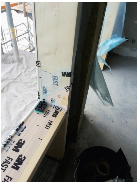
Sekundärtätning i utfackningsvägg. Lutning saknas, men vatten blir åtminstone stående på den täta tejp. Träregelein skyddas under byggtid samt även senare när vatten tränger in genom fönstret vid slagregn.
