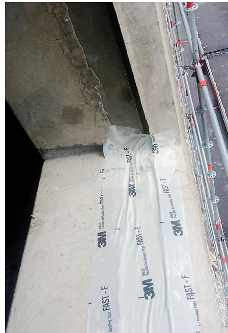
Sandwichväggar i betong där öppningen mellan stomme och fasadskiva förseglas med sekundärtätning innan fönstermontage.
