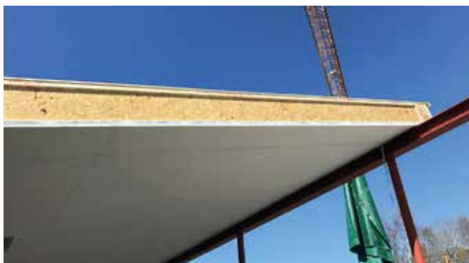
Figur 4: Oluftade takkonstruktioner med organiskt material. Fundera på om det är framtiden eller en riskkonstruktion.
