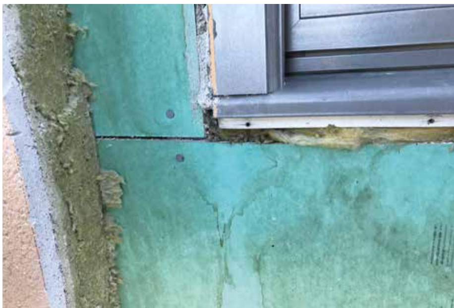
Figur 2: Skador vid tjockputs. Lärdomen är att anordna vattenutledande sekundärtätningar och stomskydd för alla typer av fasader
